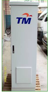
OUT DOOR MPOC CABINET
